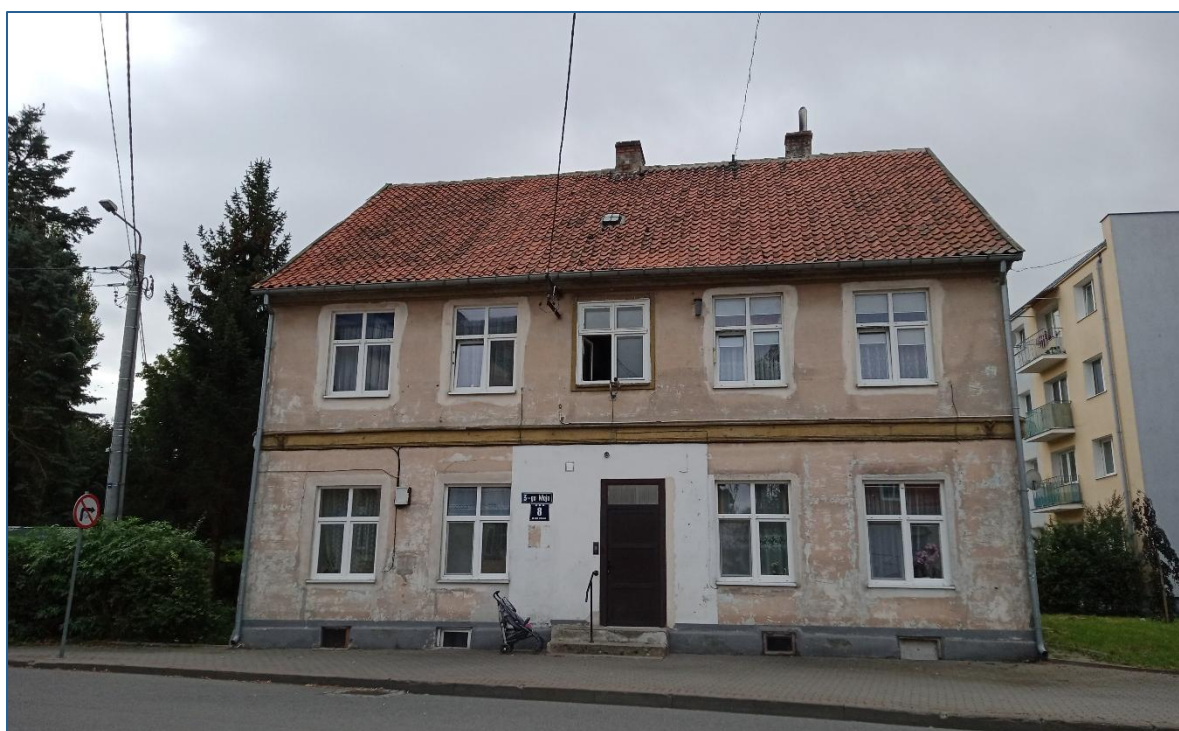
Ryc. 25 Przykłady zdegradowanej infrastruktury mieszkaniowej w Nowym Dworze Gdańskim: ul. Henryka Sienkiewicza 7, ul. Michała Drzymały 11, ul. 3-go Maja 8
